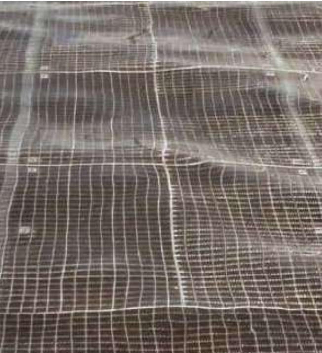
Rist af rustfrit stål under vandspejl. Hvor risten som oftest er under vandspejlet, anvendes enten galvaniseret eller rustfrit stål.
