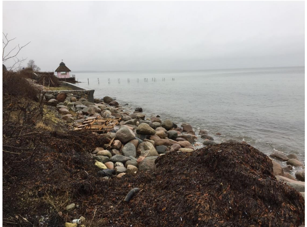
Figur 3-17 Kysten set mod nord fra syd for det lyserøde lysthus på delstrækningen Bukkeballevej til Rungsted Havn.
