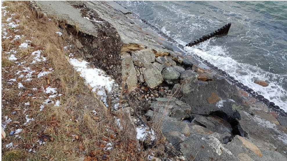
Figur 3-29 Billede af skade på kystbeskyttelse.
