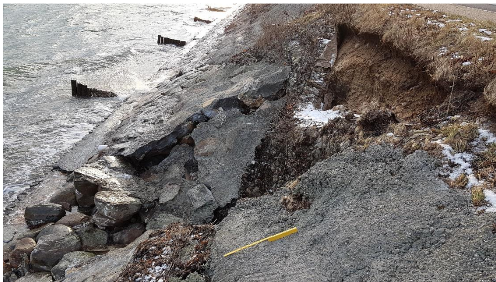
Figur 3-27 Billede af skade på kystbeskyttelse. Tommestok til målestok er 0,5 m.
