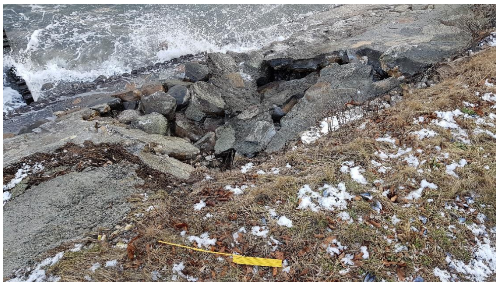
Figur 3-28 Billede af skade på kystbeskyttelse. Tommestok til målestok er 0,5 m.
