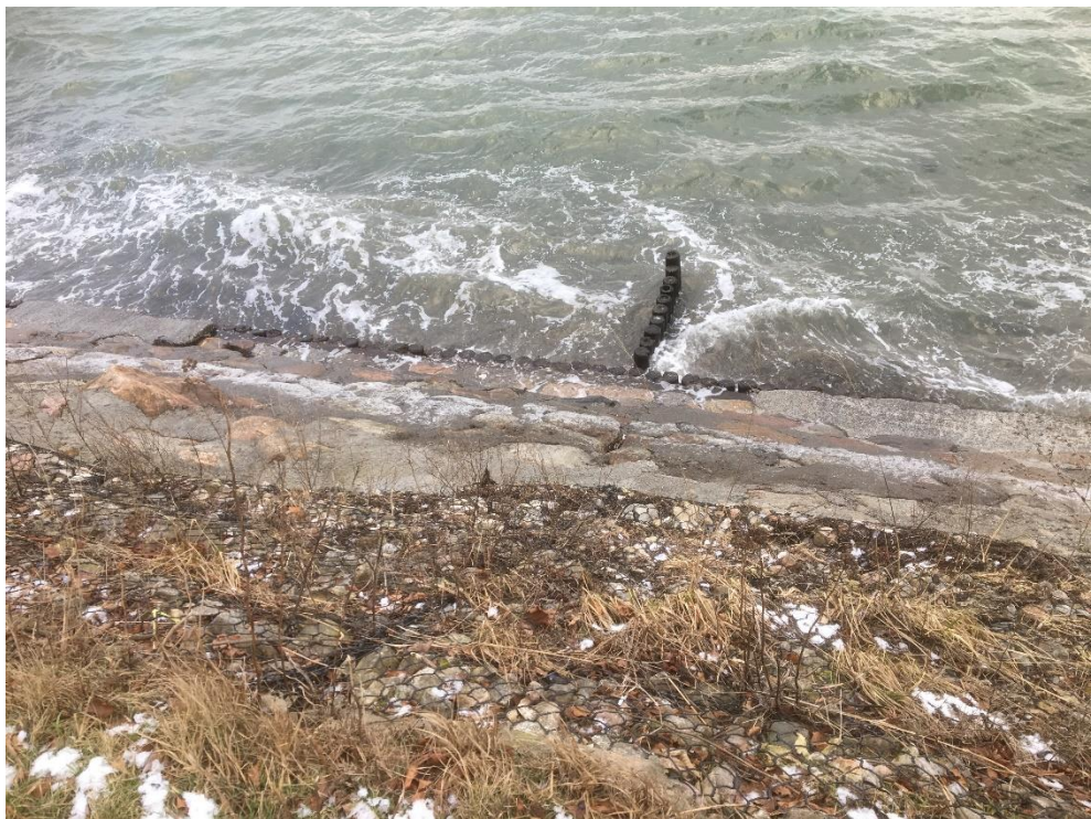
Figur 3-30 Billede af skade på foden af kystbeskyttelsen på samme kyststrækningen, syd for skaden ud for Rundsted Strandvej 219.
